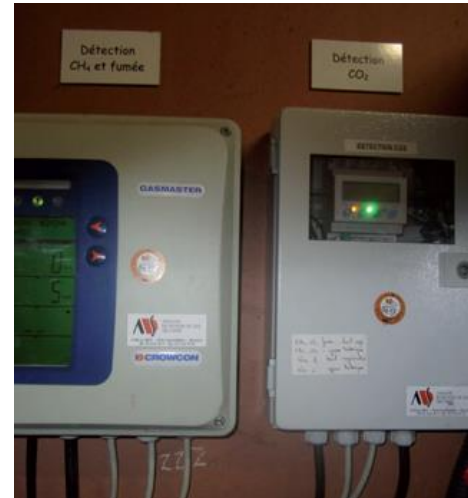
Détecteurs de gaz
